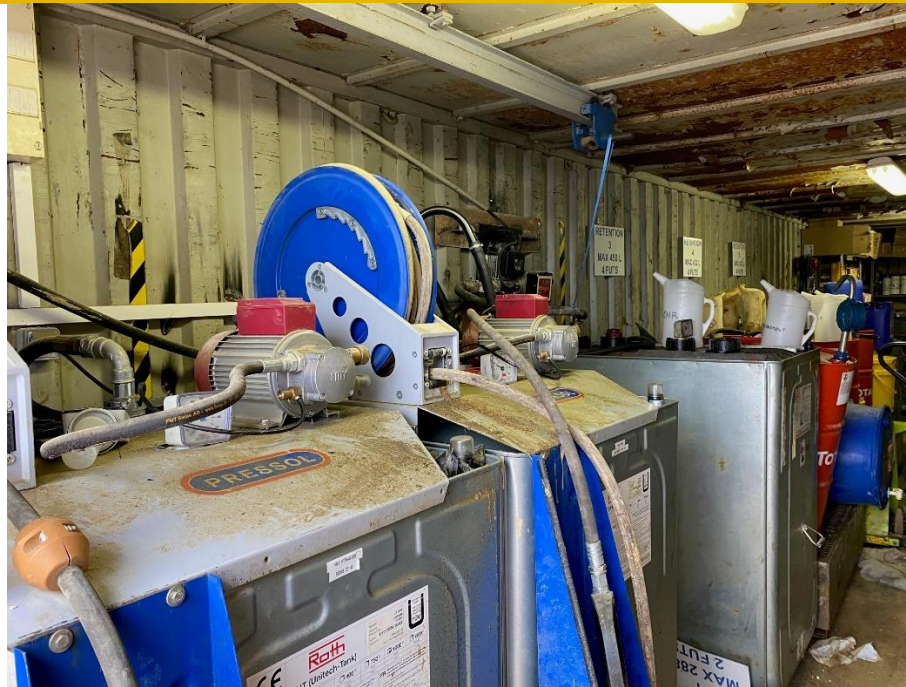
Vue des réserves de carburant à l'intérieur du local technique avec cuves de rétention.
